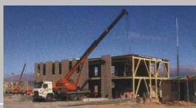
ELIT SU Water Factory
